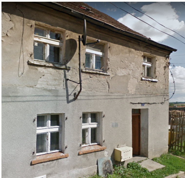
Rysunek 21. Elewacje budynków w obszarze rewitalizacji oszpecone antenami tv
